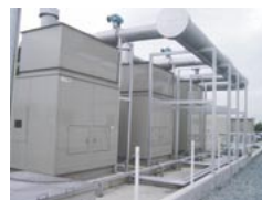
■コジェネレーションシステム
